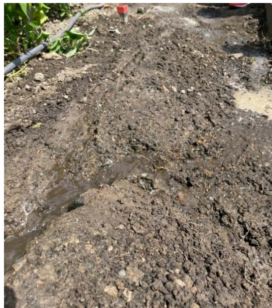
図 1 7 . 分裂した溝の内側の土が削られている様子
