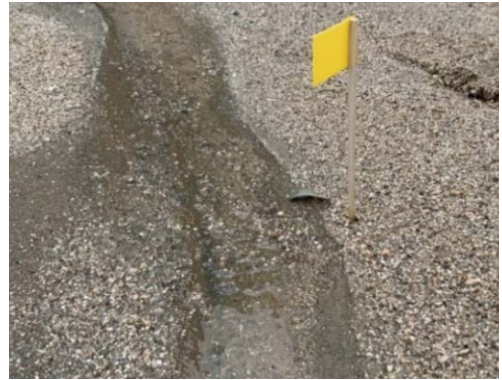
図 2 6 . 水を流した後に削られる地面の様子
